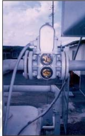
FIGURA 2.36. RELE BUCHHOLZ INSTALADO EN UN TRANSFORMADOR DE 5 MVA
