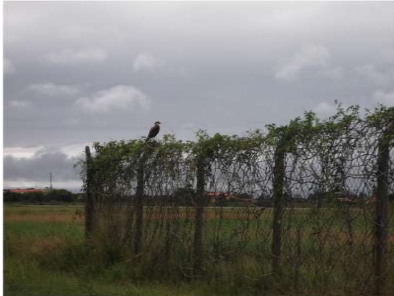
Figura N ° 23. Malla Perimetral.
