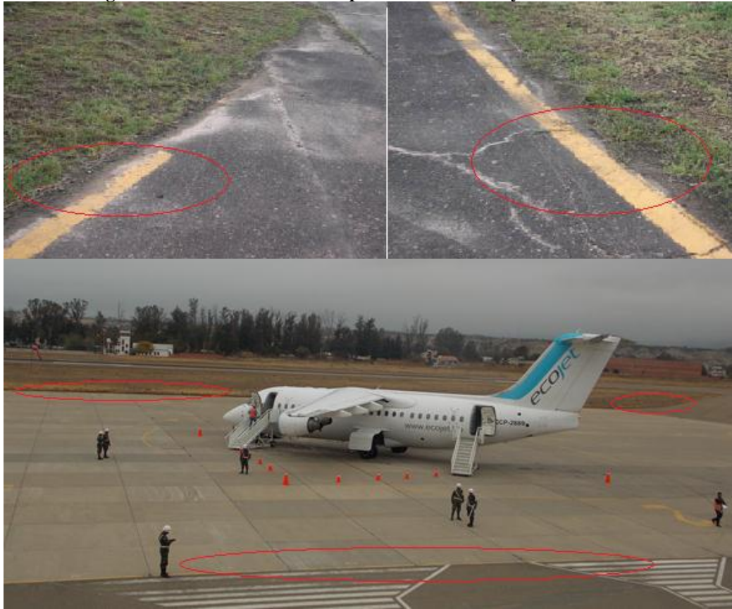
Figura N° 14. Señal de borde de plataforma borrosa y fuera de norma
