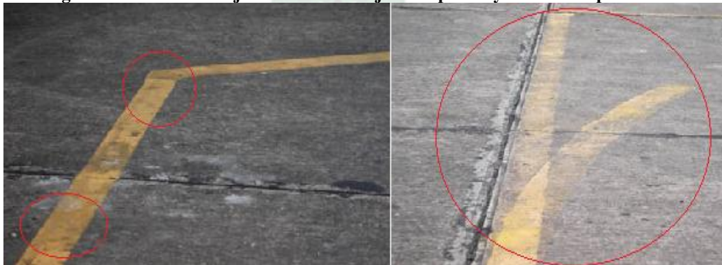
Figura N° 15. Señal de eje de calle de rodaje sobrepuesta y errónea en plataforma
