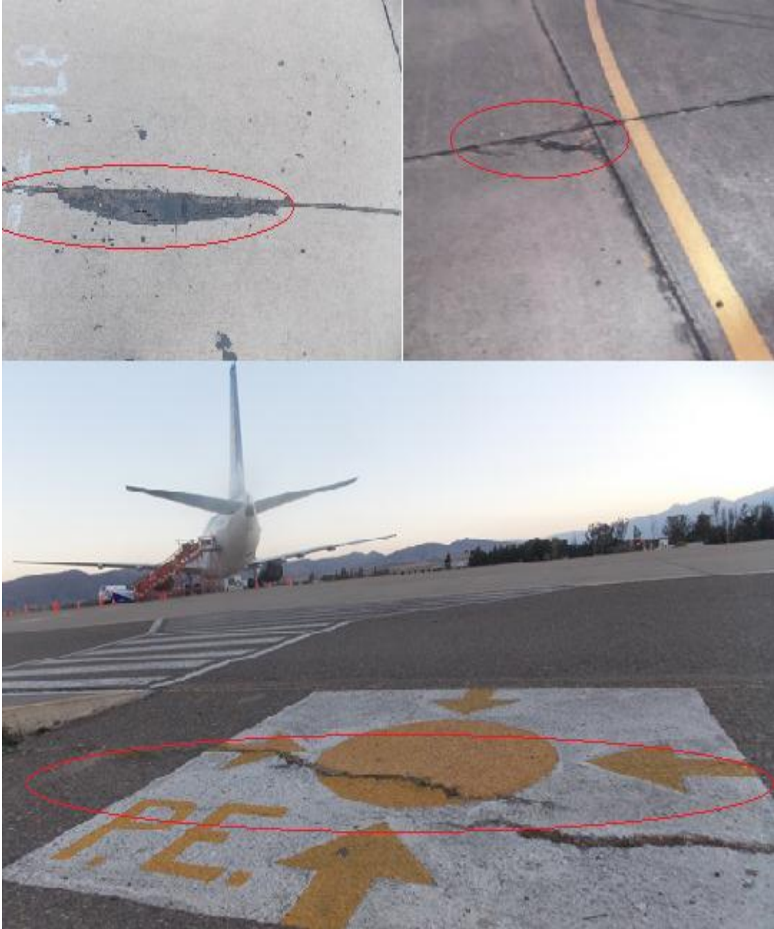
Figura N° 13. Deterioros y rajaduras en el pavimento rígido (plataforma)
