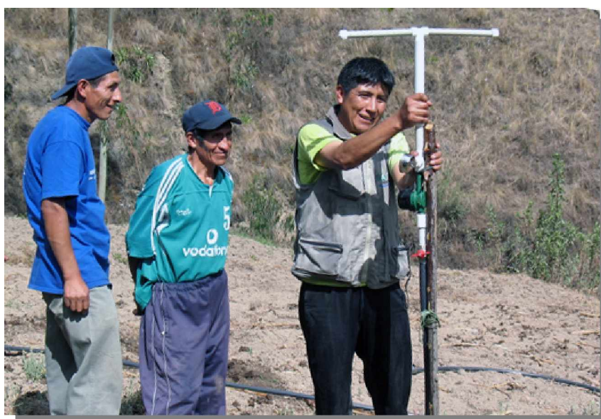
Pruebas de funcionamiento del aspersor
