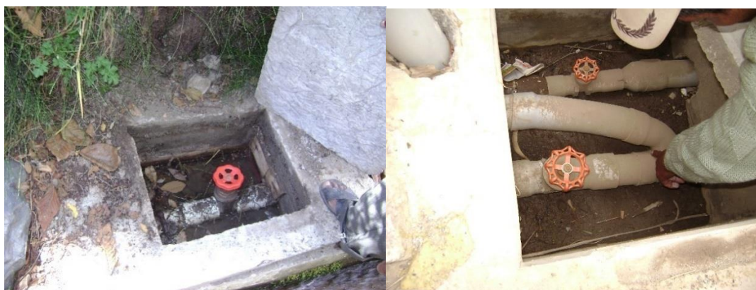
Figura 16. Cámaras de control y distribución
