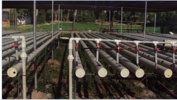
Visita a la Universidad de San Simón donde tienen el Sistema Hidropónico Recirculante NFT
