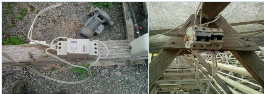
Sistema eléctrico (temporizador y térmico)
