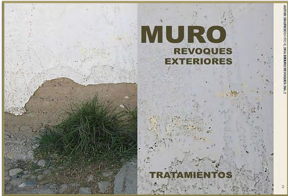
Ilustración 121. Fachada sur. Revoques exteriores. 1
