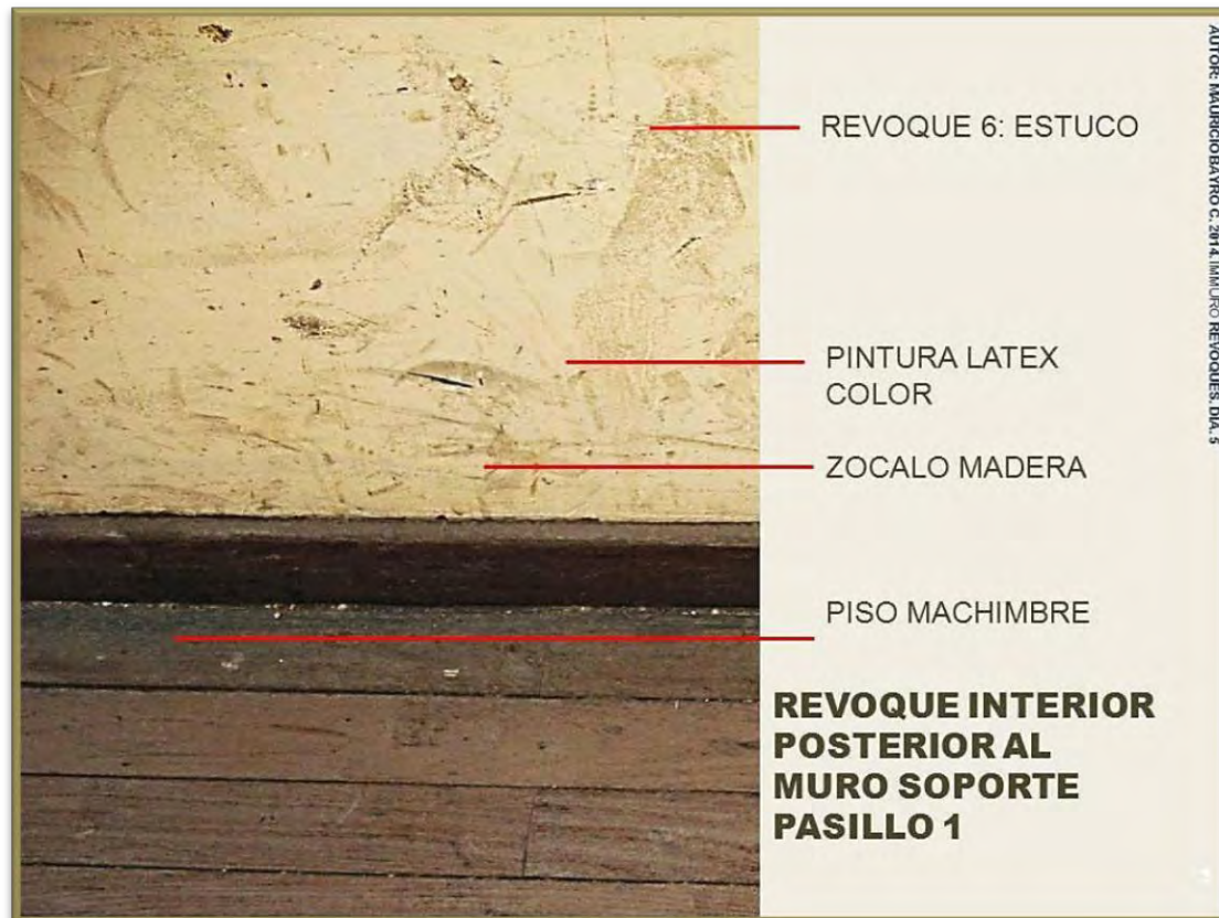
Ilustración 123. Muro y revoque en pasillo interior 1
