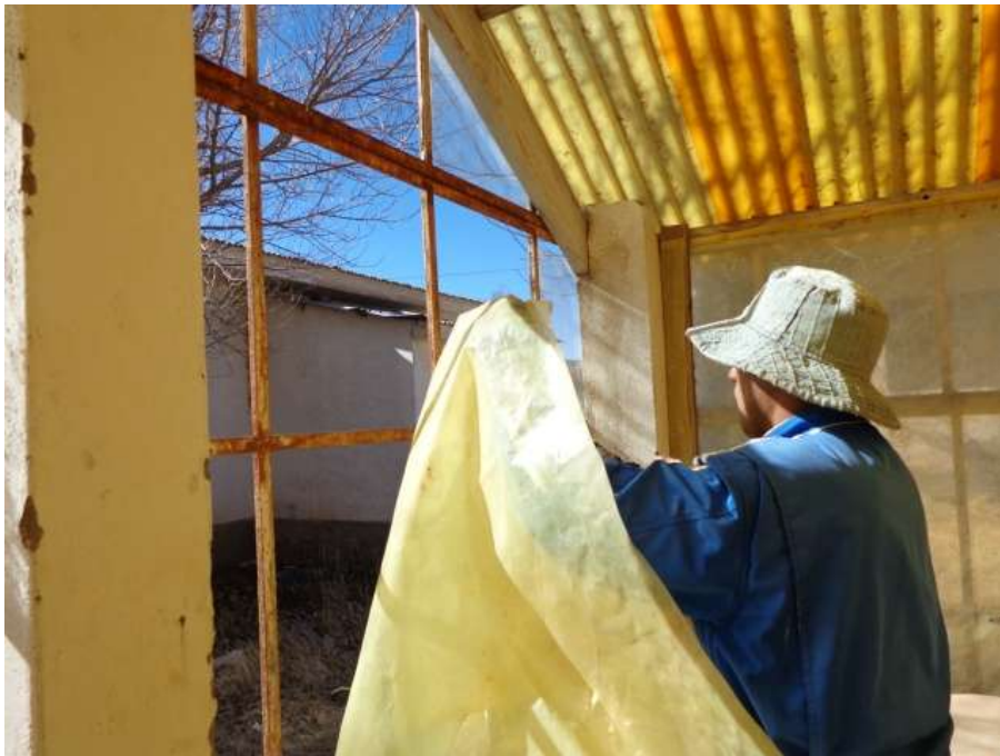
Imagen 2 se cubrió con agro fil todos los vidrios rotos del invernadero.
