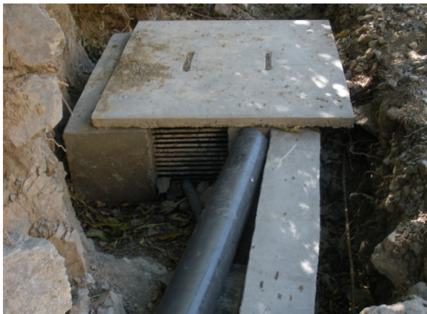
Fotografía 5. Estructuras de aducción de agua en microsistemas nuevos de riego
