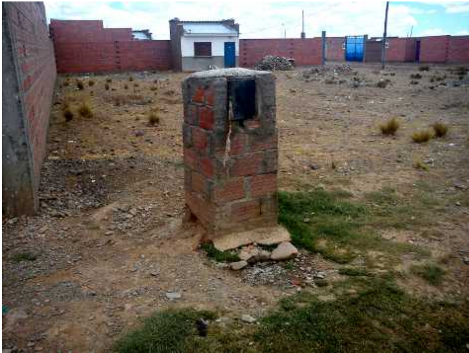
FOTO DE PILETA EN MAL ESTADO EN EL SECTOR LA FORTALEZA
