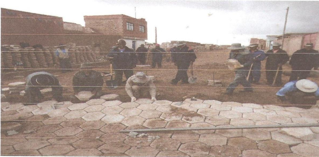
Trabajo de la Comunidad de catavi en el enlosetado de las calles de la poblacion
