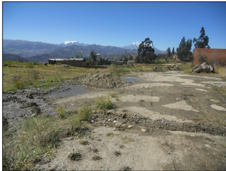
Fotografía N° 10: Red secundaria dañada
