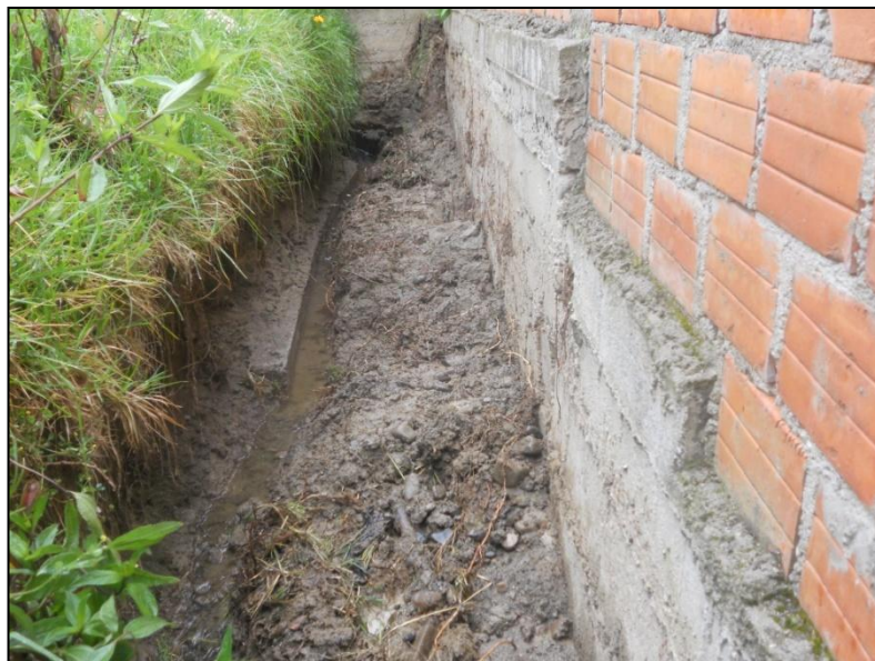
Fotografía N° 9: Desmoronamiento sobre el canal principal
