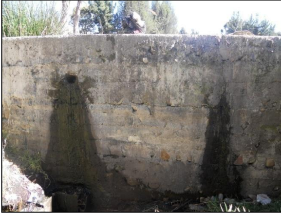
Fotografía 7: Filtraciones presa reguladora
