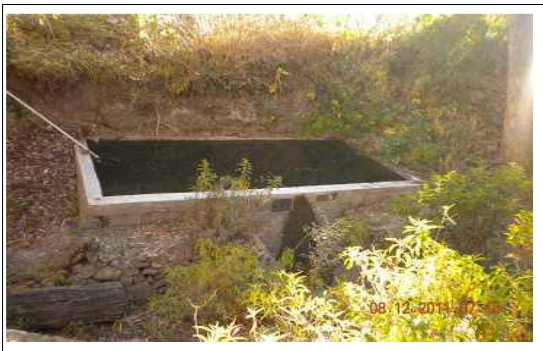
Foto N°18. Se sugirió la anulación definitiva del desagüe actual, pero la instalación de otro desagüe más arriba (coronación), para evitar el deterioro del muro principal del tanque.
