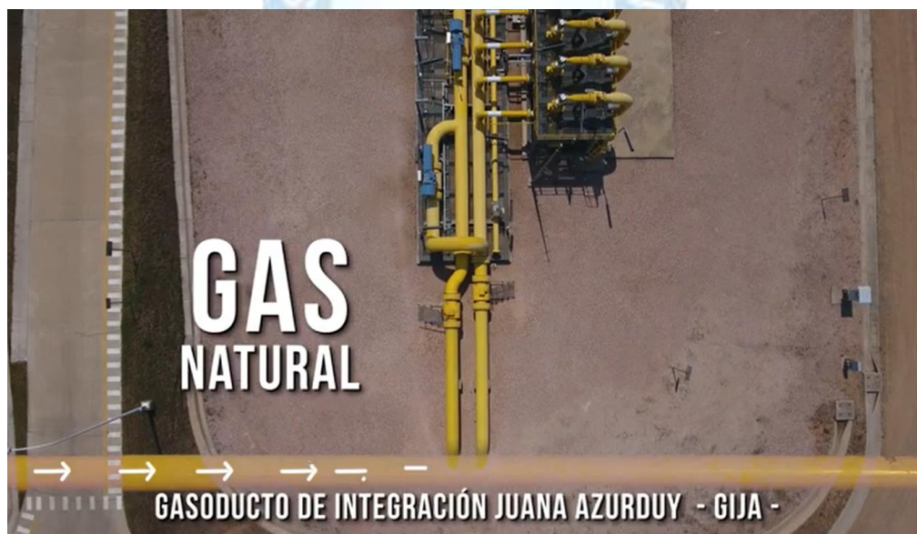
Figura 3.8 Entrada de Planta PSLCV
