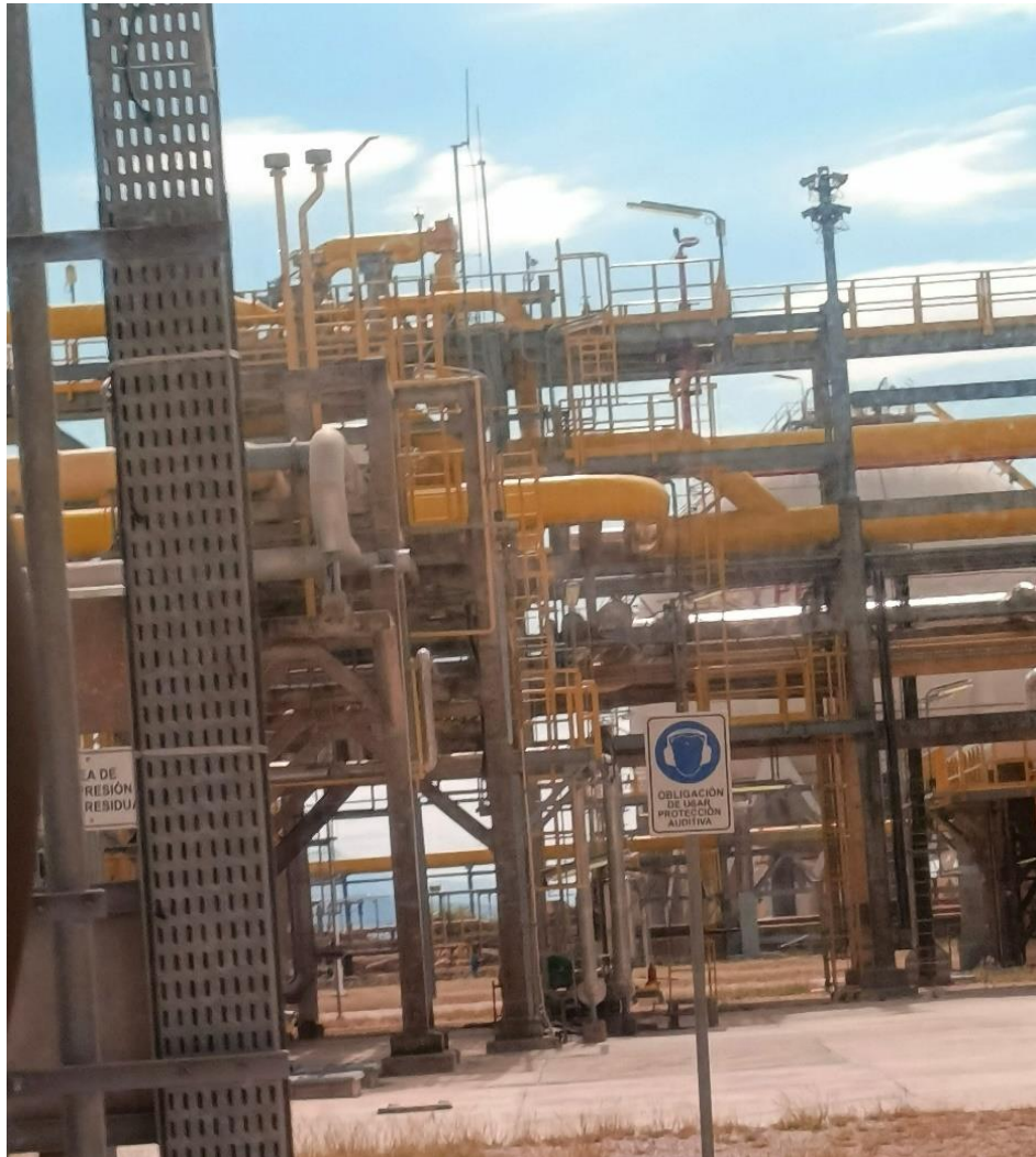
Figura 3.33. Unidad de Compresión de Gas Residual de la PSLCV
