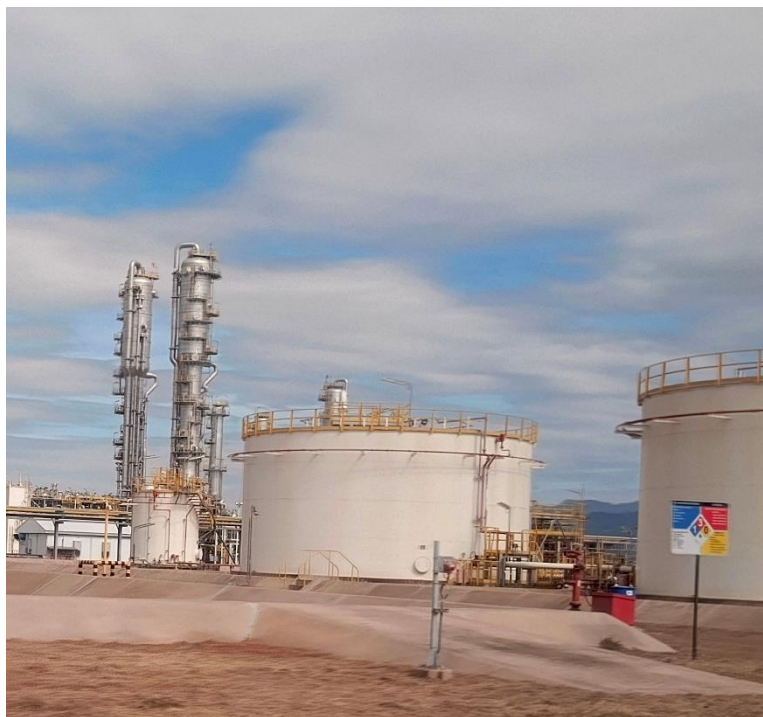
Figura 3.39 Tanque de Gasolina
