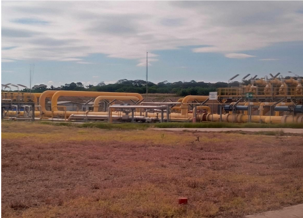
Figura 3.9. Ingreso de Gas a Planta
