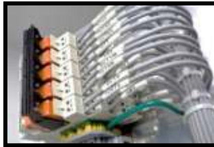
Figura 4.3. Cableado, borneras y terminales
