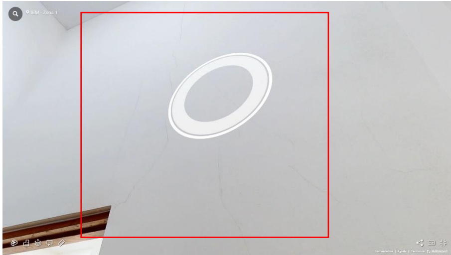
Fotografía 69 Baño 5 (Fisura en tabiquería)
