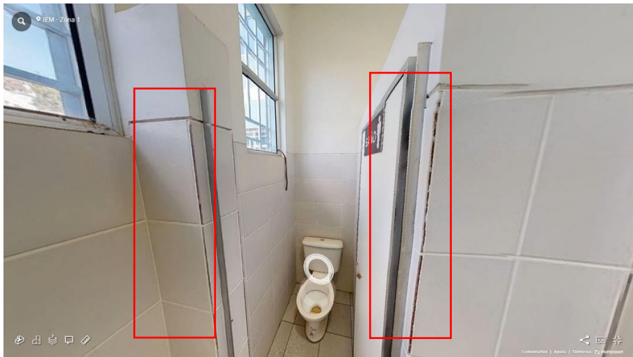
Fotografía 6 Baño 3.3 (Uniones de azulejos deteriorados)
