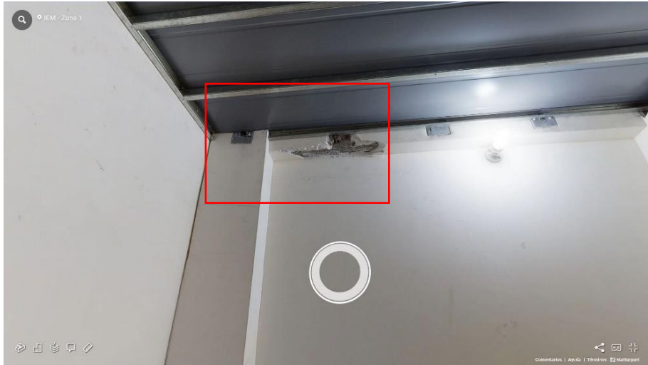
Fotografía 47 Tinglado Hormigón y Vaciado (Pared deteriorada)
