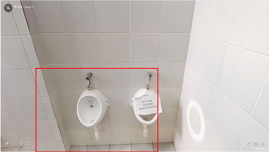
Fotografía 2 Baño 1.1 (Urinario fuera de servicio)
