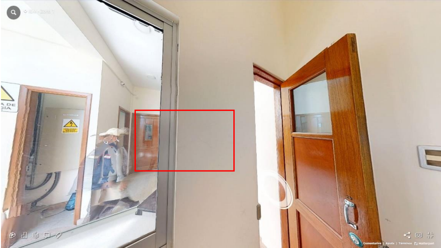
Fotografía 1 Almacén 1 (Fisuras en la Pared)
