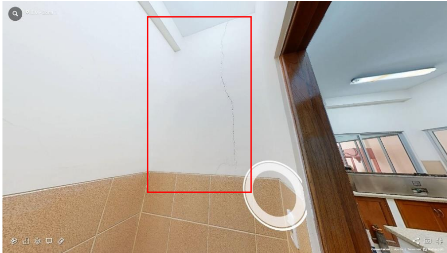
Fotografía 13 Deposito Química (Fisura)
