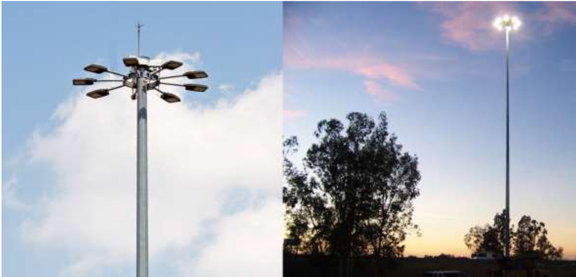
FIGURA 5-11 Imagen referencial poste de gran altura
