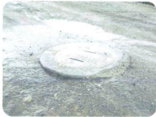
REVALSE DE LAS ALCANTARILLAS SANITARIAS
