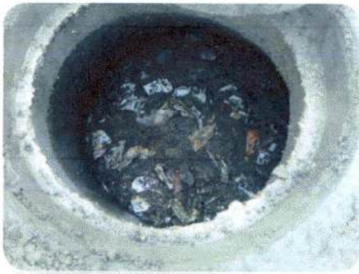
TODO TIPO DE BASURA EN LAS ALCANTARILLAS SANITARIAS
