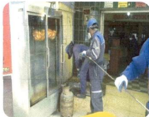
RESTAURANTES CAUSANTES DE LOS TAPONAMIENTOS DEL ALCANTARILLADO SANITARIO
