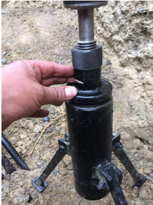
Fotografía 40. Los dispositivos que sostienen el cilindro hidráulico cuentan con tornillos de nivelación.
