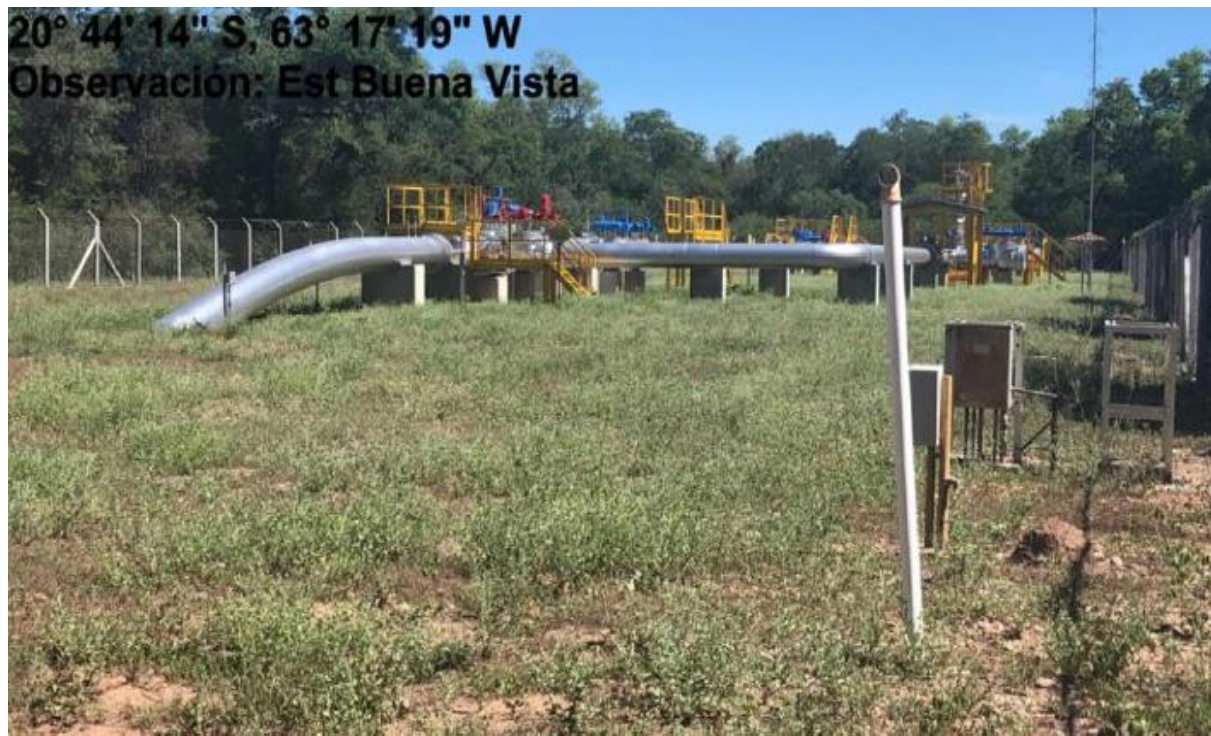
Estación de medición operativa "BUENA VISTA"
