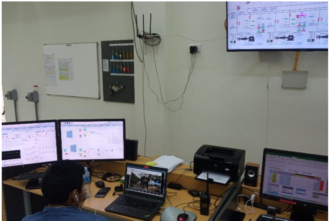
Sala de control Estación de Medición Río Grande.
