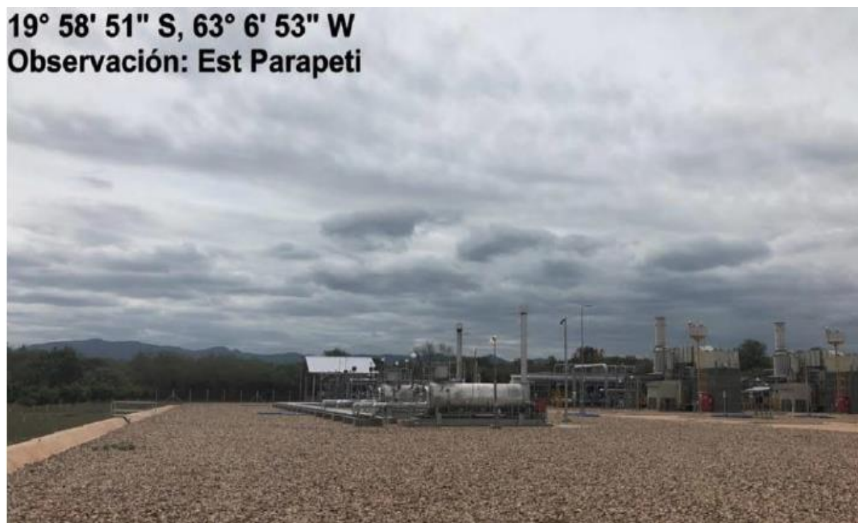
Estación de compresión "PARAPETÍ"
