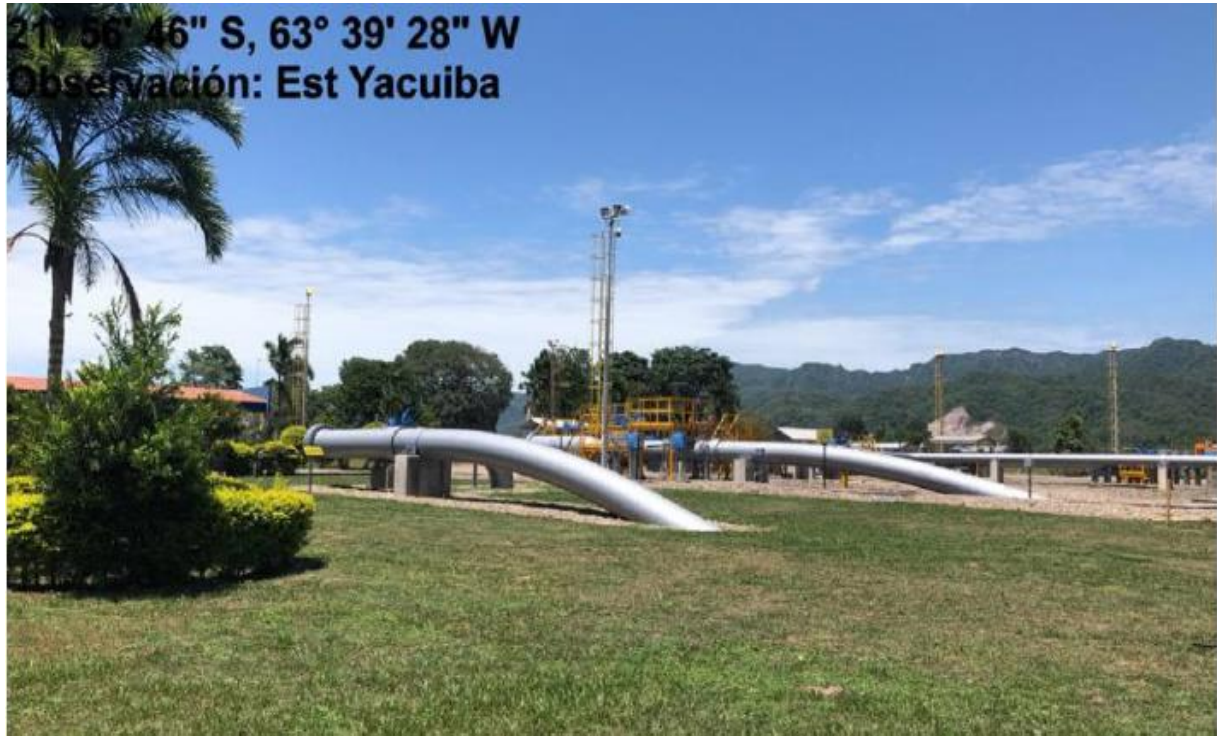
Estación de Control y Medición “YACUIBA”
