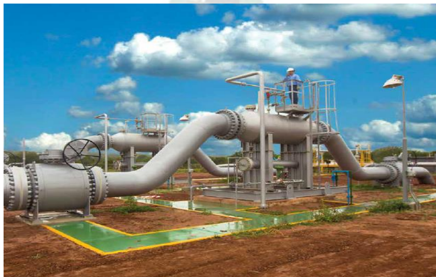
Figura 2.1 Estación de Compresión Parapetí
