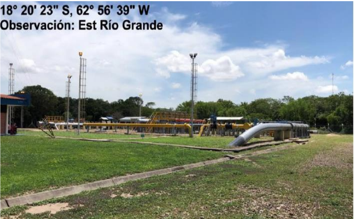
Estación de medición "RÍO GRANDE"
