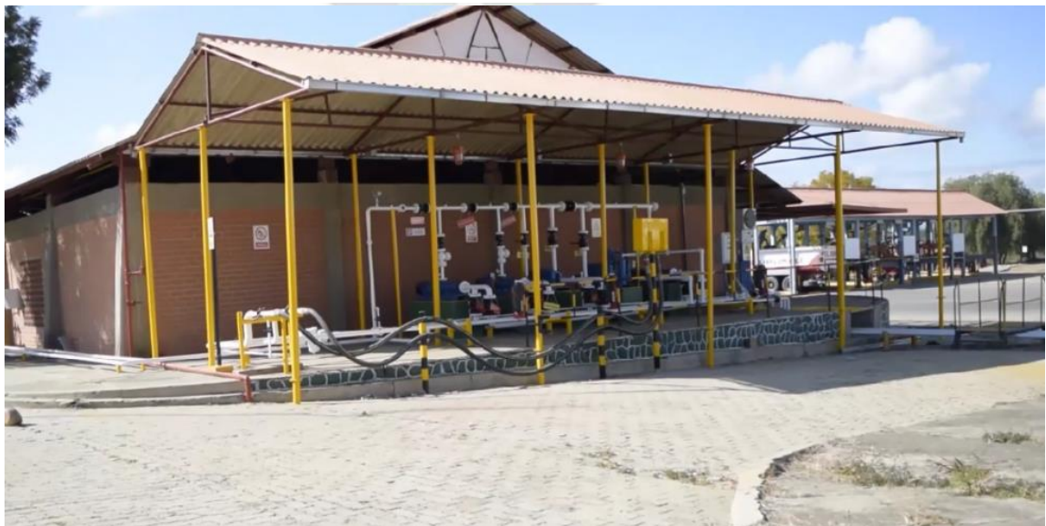
Figura 2.20 Área de bombas y compresores
