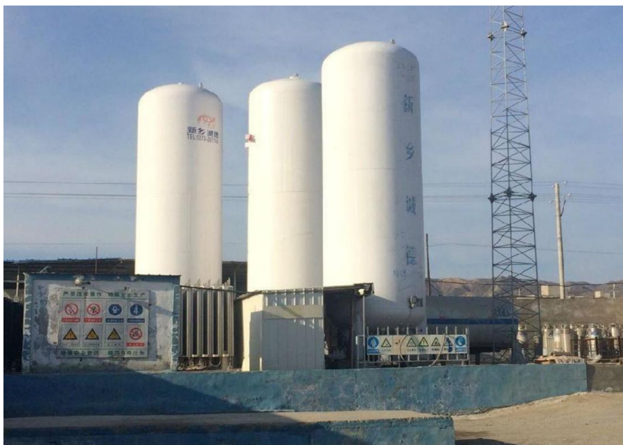
Figura 2.2 Tanques a presión verticales
