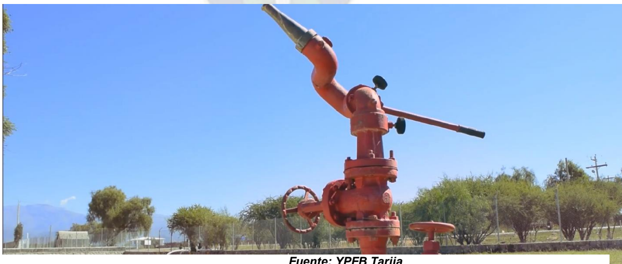
Figura 4.30 Hidrantes de la planta engarrafadora Tarija.
