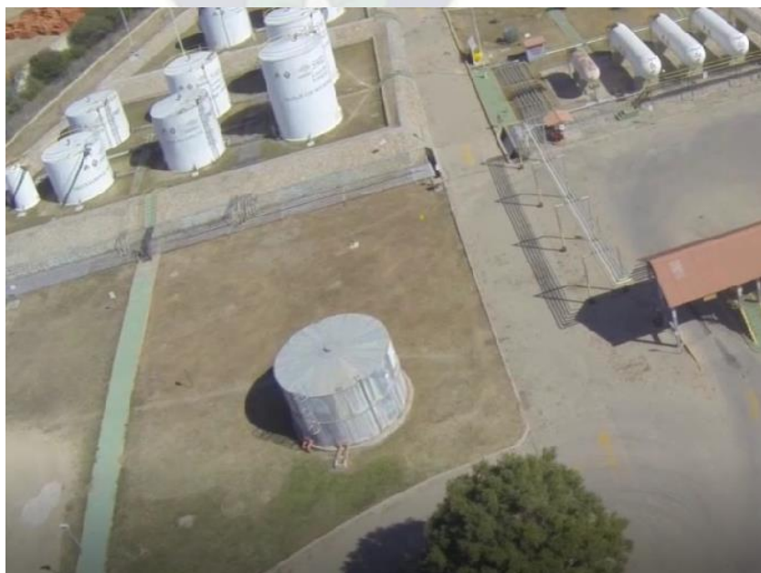
Figura 2.27 Tanque de agua del sistema contra incendios
