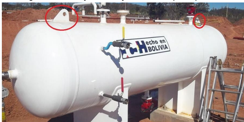
Figura 2.12 Orejas de izaje en un tanque a presión
