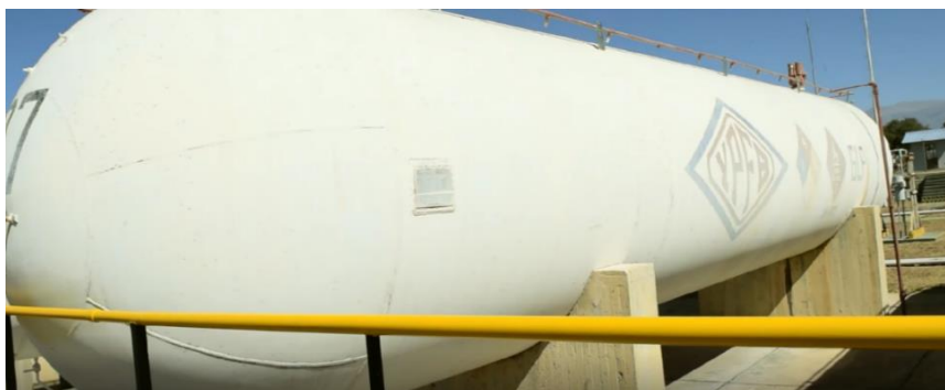
Figura 2.28 Tanque con instalación de sistema de refrigeración contra incendios
