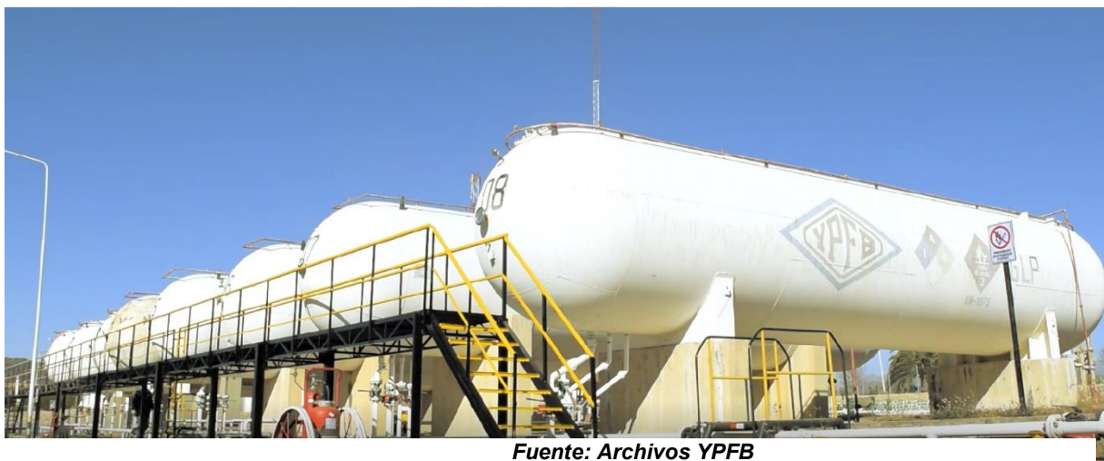
Figura 2.16 Tanques de GLP Planta engarrafadora Tarija Bolivia
