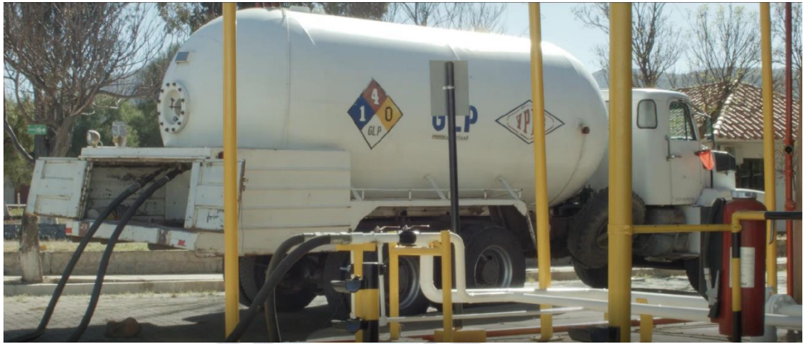
Figura 2.21 Despacho de GLP a cisterna
