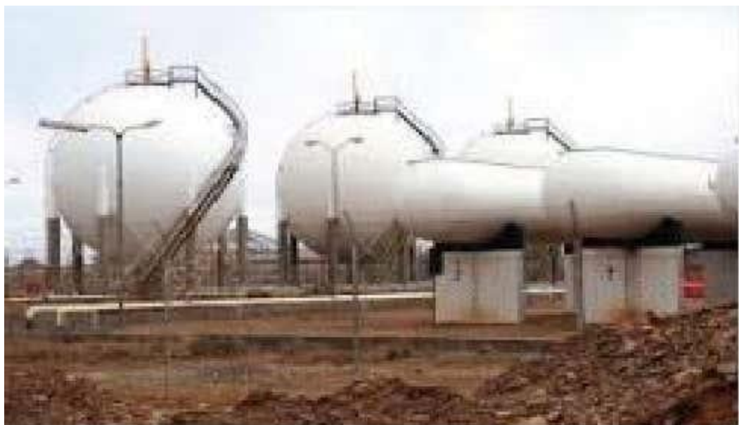
Figura 5 Vista de los tanques instalados en Planta de Senkata
