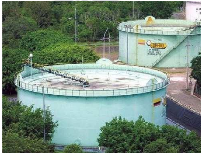
Figura 13 Tanque Cilíndrico con Techo Flotante
