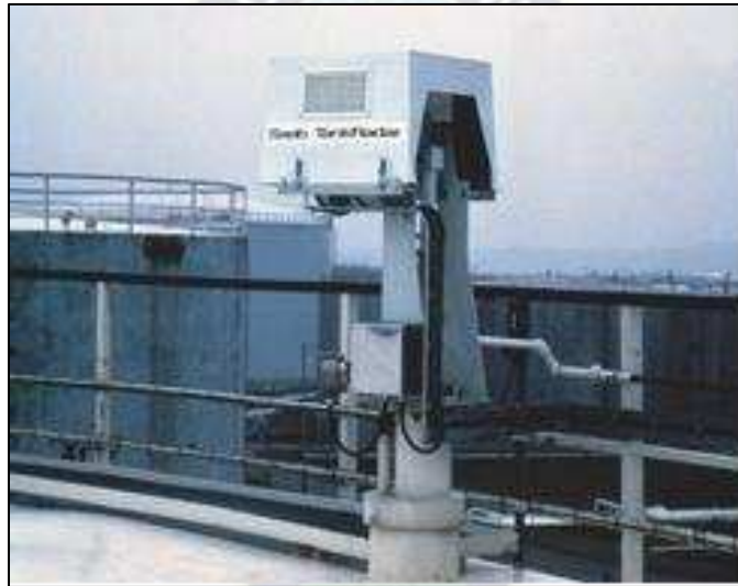
Figura 31. Primer medidor por radar de alta precisión instalado en 1985 en un tanque de refinería. Fuente: : La guía del ingeniero de tanques de almacenamiento, 2021.
