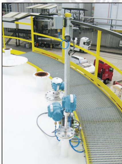
Figura 39. Antena conectada a dispositivos del tanque. Fuente: La guía del ingeniero para la medición de tanques, 2021.
