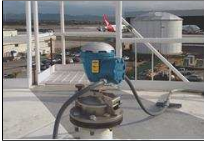
Figura 32. Medidor de nivel por radar moderno en un tanque de techo fijo. Fuente: Emerson2021
