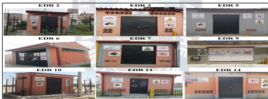
Figura 2-12 Compendio de fotos de EDR's con caseta de mampostería.
