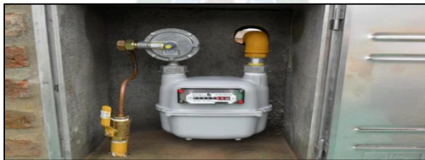
Figura 2-16 Gabinete de medición.
