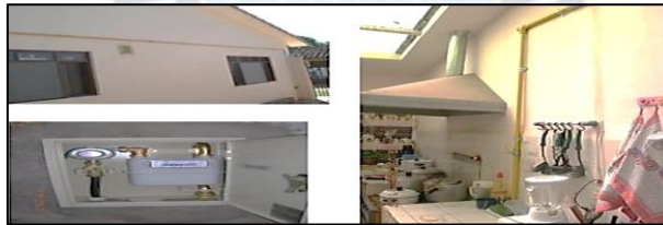
Figura 2-15 Instalación interna y gabinete de medición.
