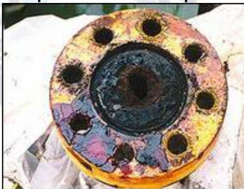
FIGURA 2.7 Deposición severa de parafina en tubería
