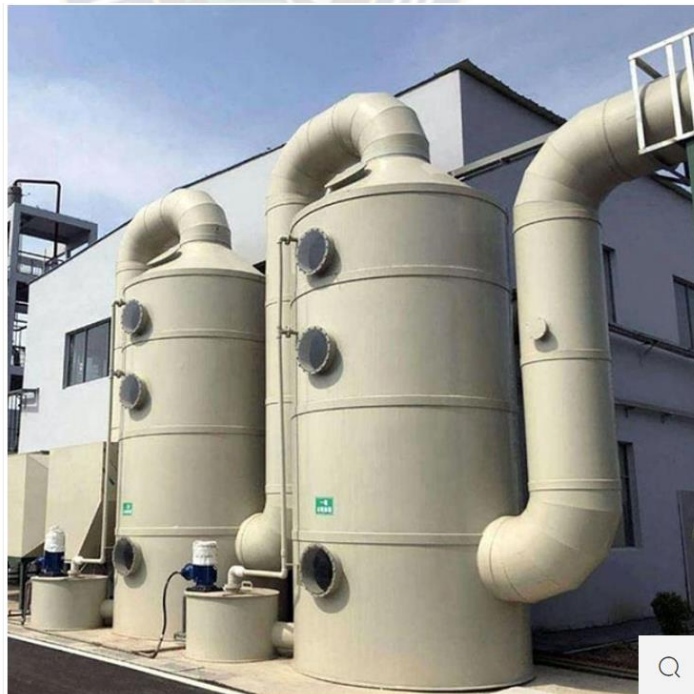
Figura 5.1: Equipo de eliminador depurador de H 2 S.
