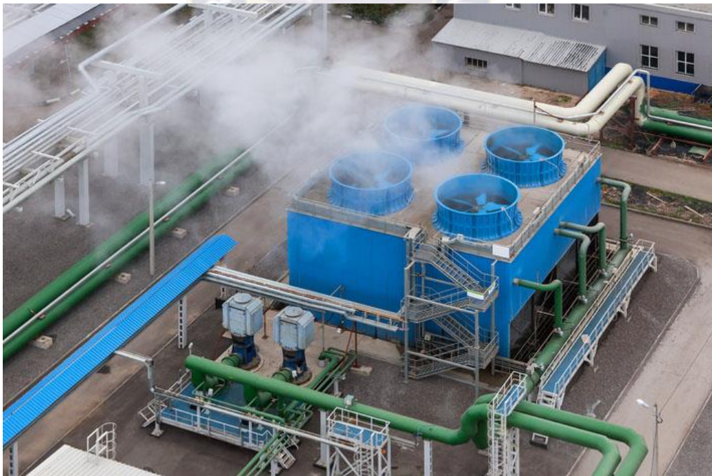
Figura 5.5: Torres de refrigeración instaladas en plantas Geotérmicas.
