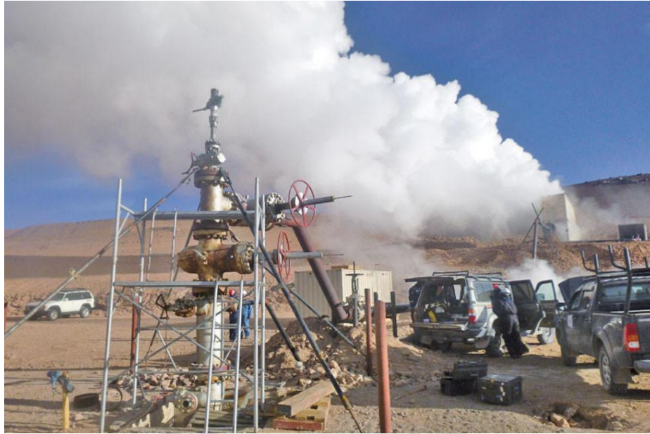
Figura 4.3: Inspección de ENDE a los cabezales de pozos.
