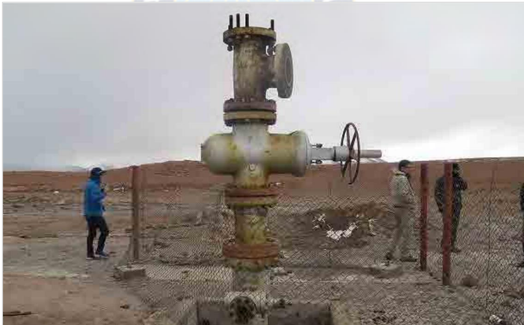
Figura 4.9: Estado físico de Cabezal de pozo.
