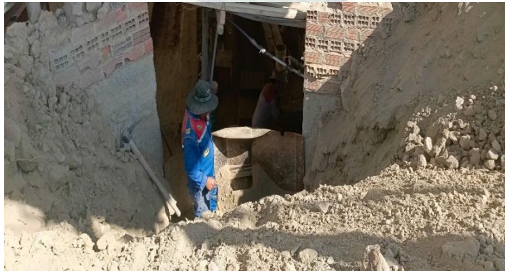
Ilustración 3. 5 LADRILLERA EMANUEL: PROCESO DE TRATAMIENTO MECANICO PREVIO
