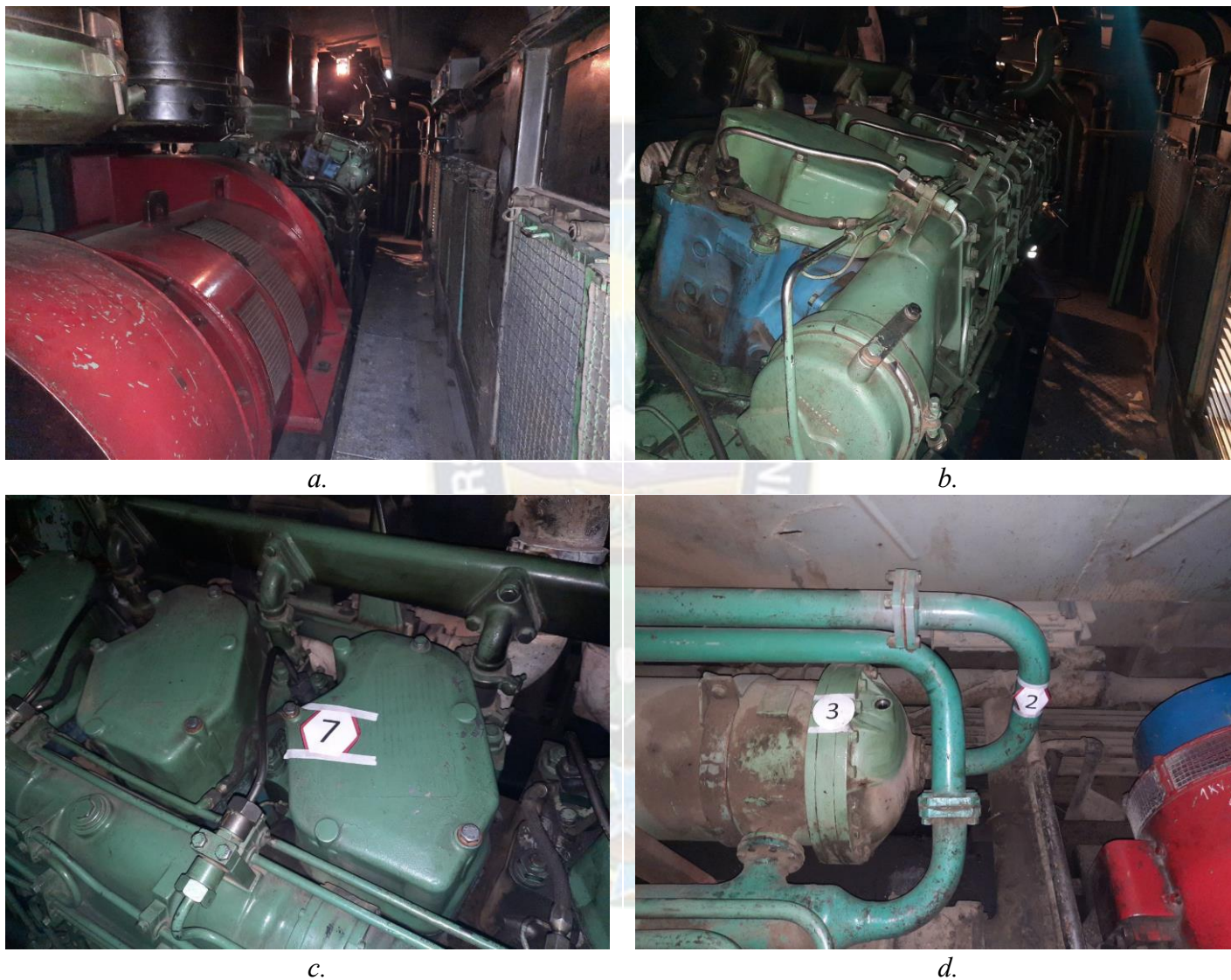
Figura 14. Puntos de medición marcados en el motor: a. vista de la sala de máquinas, b. vista del motor, c. culata, d. tubería del aceite enfriado (2) y el enfriador de aceite (3).
