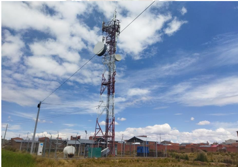
Figura. 3.8 Estación base situado en la localidad Santiago de Machaca por parte de la empresa de Telecomunicaciones ENTEL S.A.
