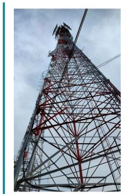
ÁREA DE ALTA FRECUENCIA
