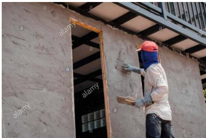
Figura 2.1 Revoques en paredes y tumbados (oficial, 2010)
