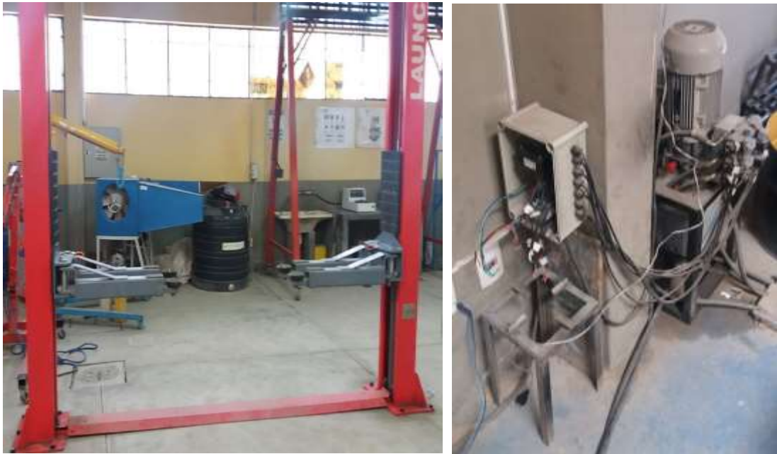
ANEXO 18 PUESTA EN FUNCIONALIDAD DE EQUIPOS DE APOYO DEL C.D.A.
