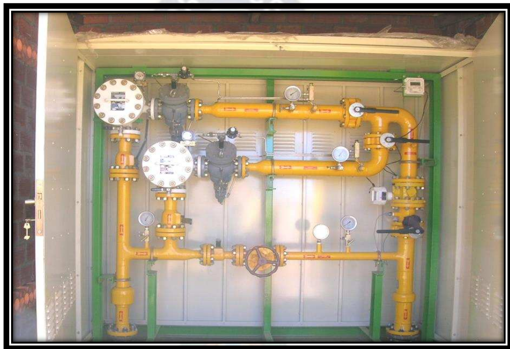
Figura 1. 2: Estacion Distrital de Regulaicon (EDR)
