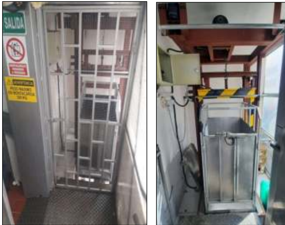
Gráfico 4: Sala de montacarga y maquina
