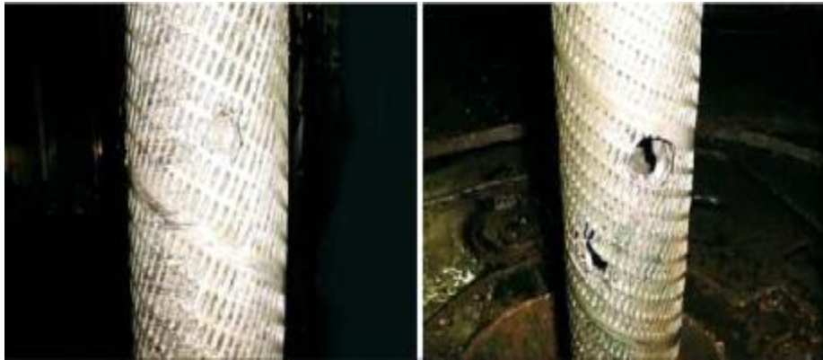
Figura 13. Erosión de filtros en el fondo del pozo
