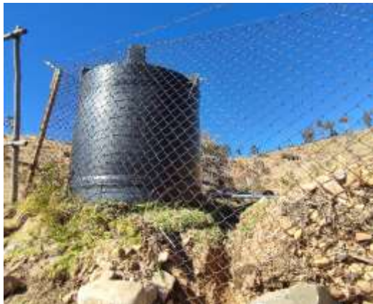
Fuente: Agua Potable, Fotografía: Ticona Mamani Jacqueline. 04-06-2023.
