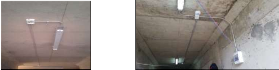
Figura 7. Instalación de equipos al interior de la galería en la presa Pampalarama
