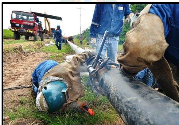
FIGURA 4-13: Reparación de un poliducto afectado por daño ocasionado
