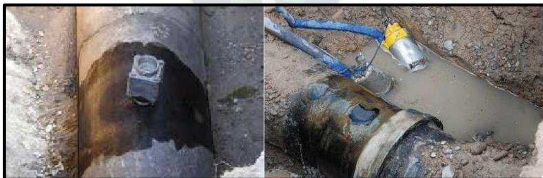
FIGURA 4-11: Tubería afectada por perforaciones de terceros
