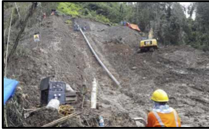
FIGURA 4-12: Poliducto afectado por derrumbe
