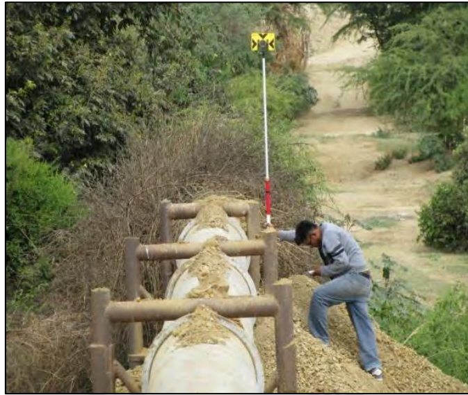
Fuente: Ducto afectado por pérdida de apoyo, Internet
