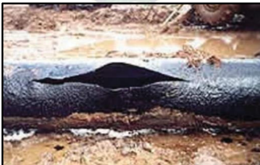
FIGURA 2-11: Tubería afectada por corrosión
