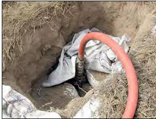
FIGURA 2-15: Toma clandestina de hidrocarburo.
