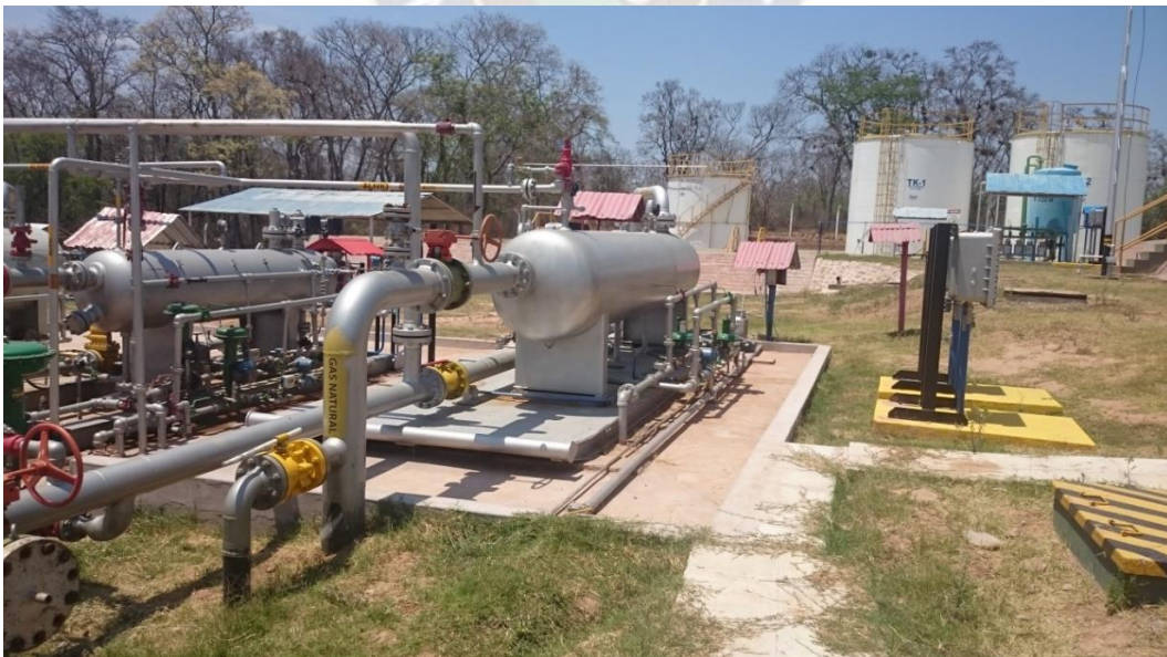
Figura 4. Separador de la Batería Fuente: Vintage Petroleum Boliviana LTD., 2019
