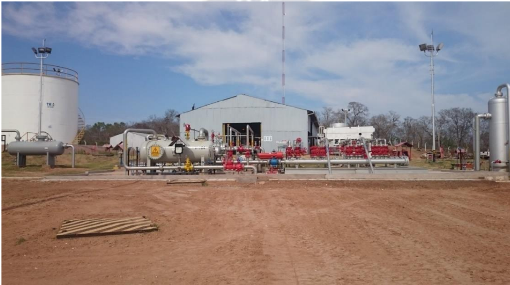
Figura 2. Vista General de la Bateria de Ñupuco Fuente: Vintage Petroleum Boliviana LTD., 2019
