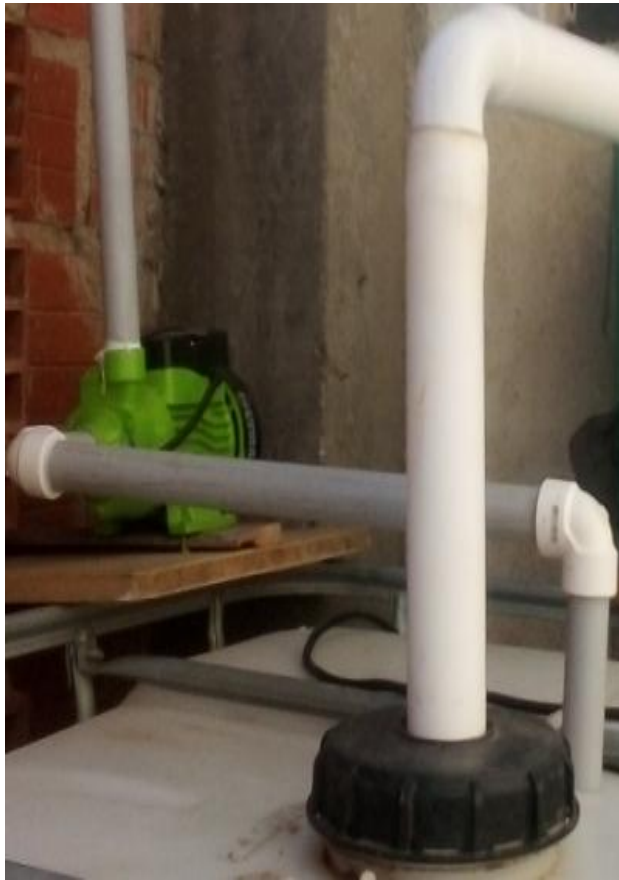
Conexión de bomba de
