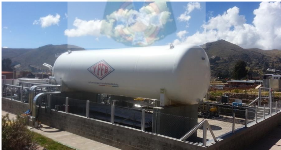
Figura 7. Tanque de Almacenaje de GNL
