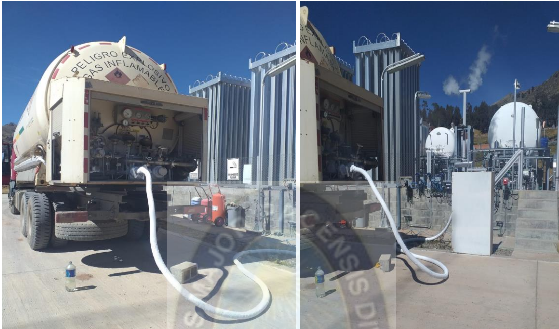
Figura 2. Descarga de GNL
