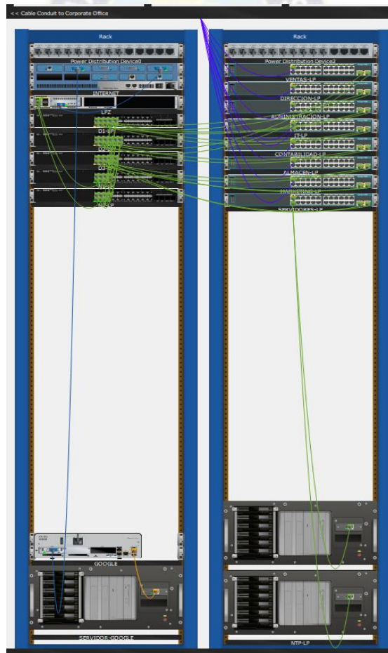
Figura 28 Equipo en el rack 1 y rack 2 para el cuarto de telecomunicación
