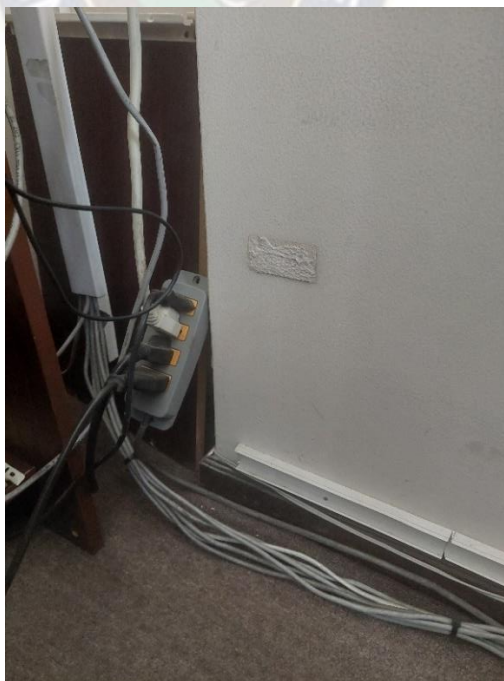
Figura 3 Cableado de la oficina EMSYT
