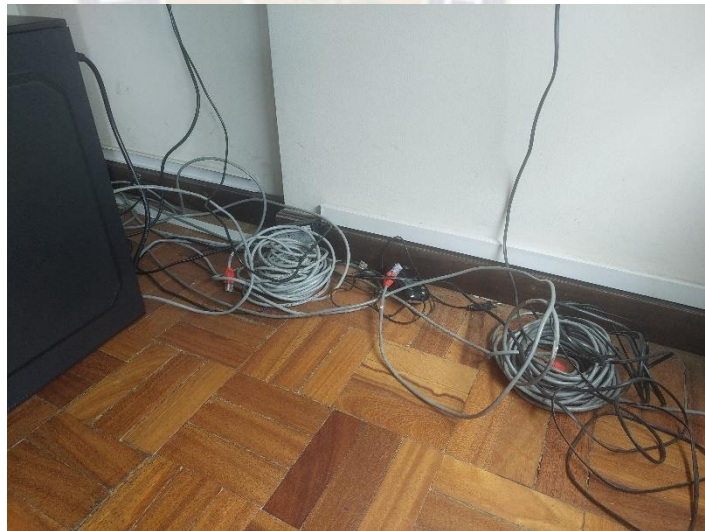
Figura 8 Cableado de las aulas de EMSYT manejado de forma inadecuada
