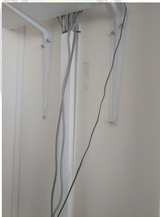
Figura 5 Cableado de la oficina de EMSYT con mala manipulación
