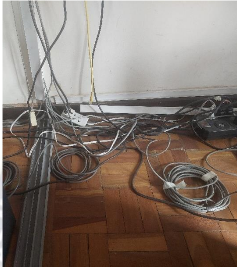
Figura 7 Cableado desorganizado en la distribución de las aulas
