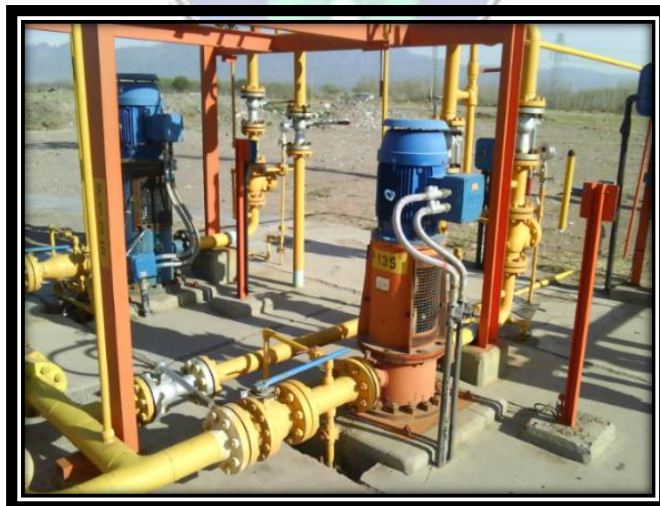
Figura 2. 13 Proceso de encendido de bombas
