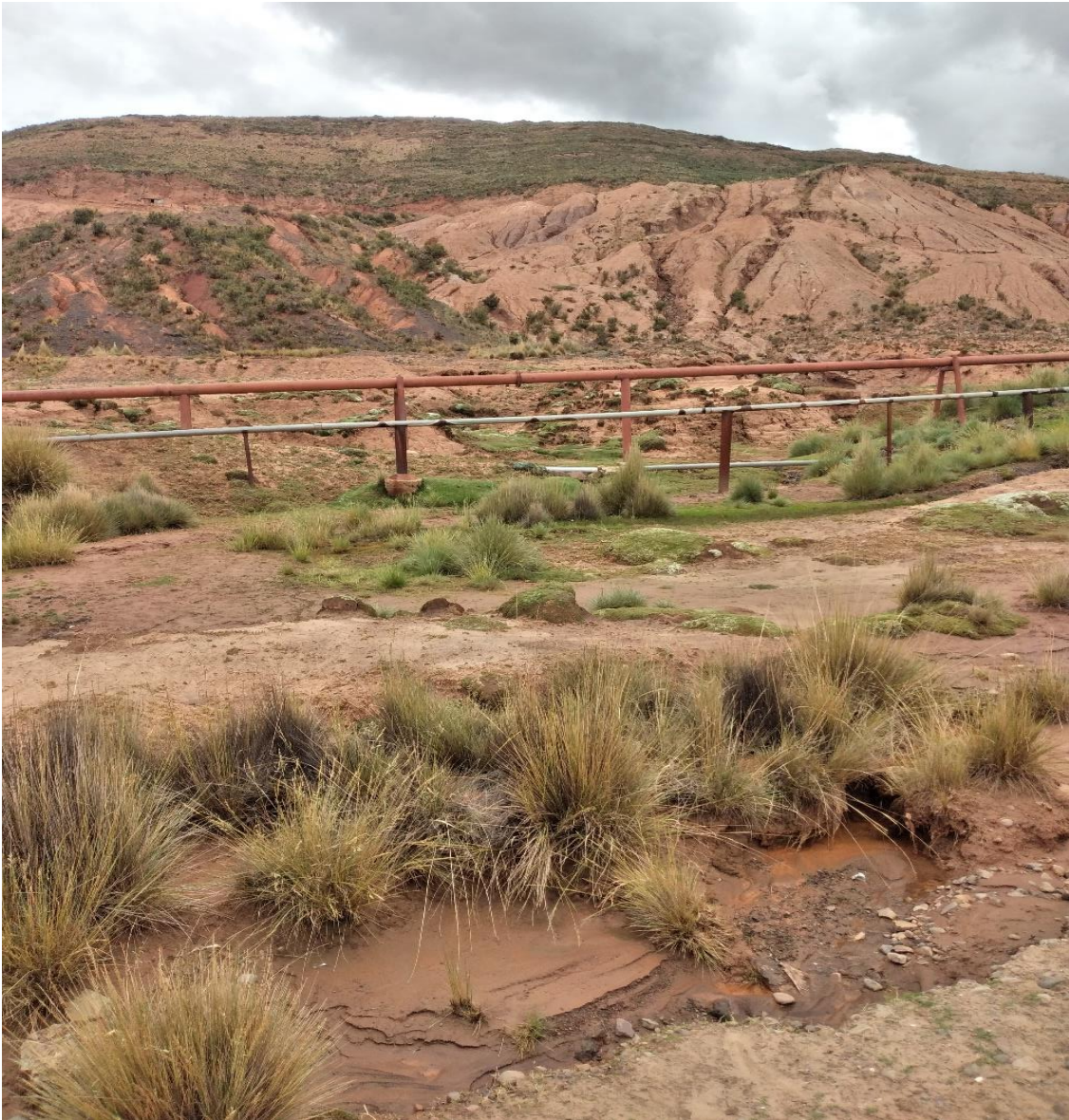
RED DE TUBERÍAS DE CONEXIÓN DE AGUA QUE INGRESA A LA LOCALIDAD DE COROCORO
