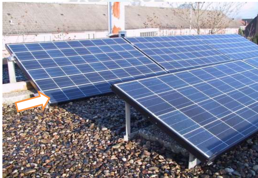
Figura N° 2.11: Ubicación deficiente de paneles fotovoltaicos
