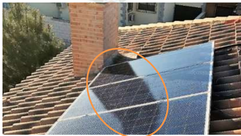
Figura N° 2.9: Sombra parcial por presencia de chimenea en techo
