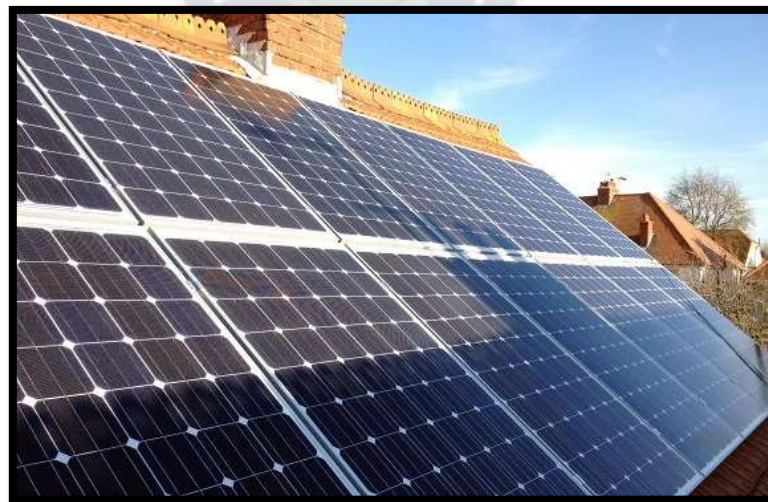
Figura N° 2.14: Sombras total y parcial producto de una mala instalación
