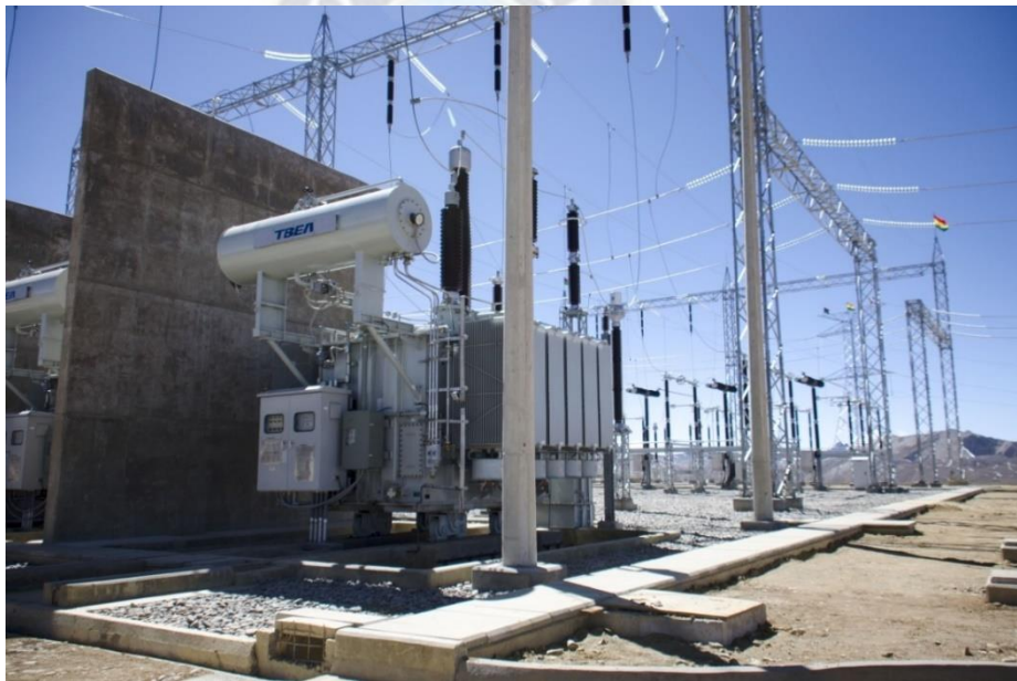
Figura 4.2. Transformador Cumbre con relación de transformación de tensión 230/115 kV
