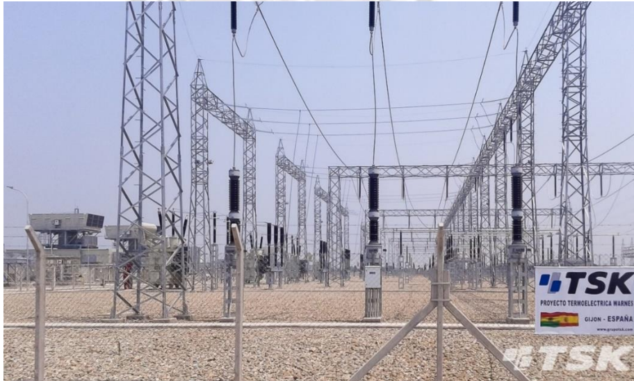
Figura 2.4. Subestación Warnes (Santa Cruz)
