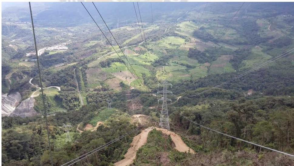
Figura 4.1. Línea de transmisión Santiváñez – San José con un nivel de tensión de 230 kV. Ubicado en el departamento de Cochabamba - Bolivia Fuente: https://www.ende.bo/public/imgs/notice/linea.jpg
