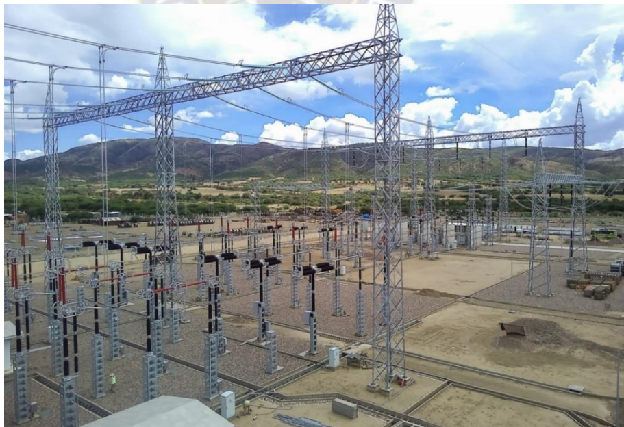
Figura 2.3. Subestación Santivañez (Cochabamba)
