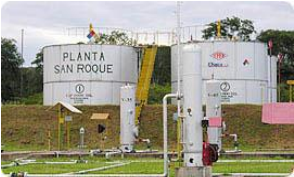
Figura 1.2. Tanques de almacenamiento de la Planta de San Roque
