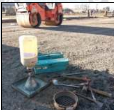
Figura 48. Equipo Cono de Arena – Construcción doble vía El Alto – Viacha Fuente: Elaboración Propia
