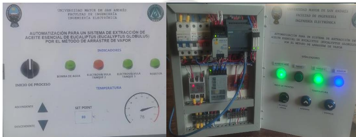
Figura 66 - Interfaz gráfica y tablero eléctrico
