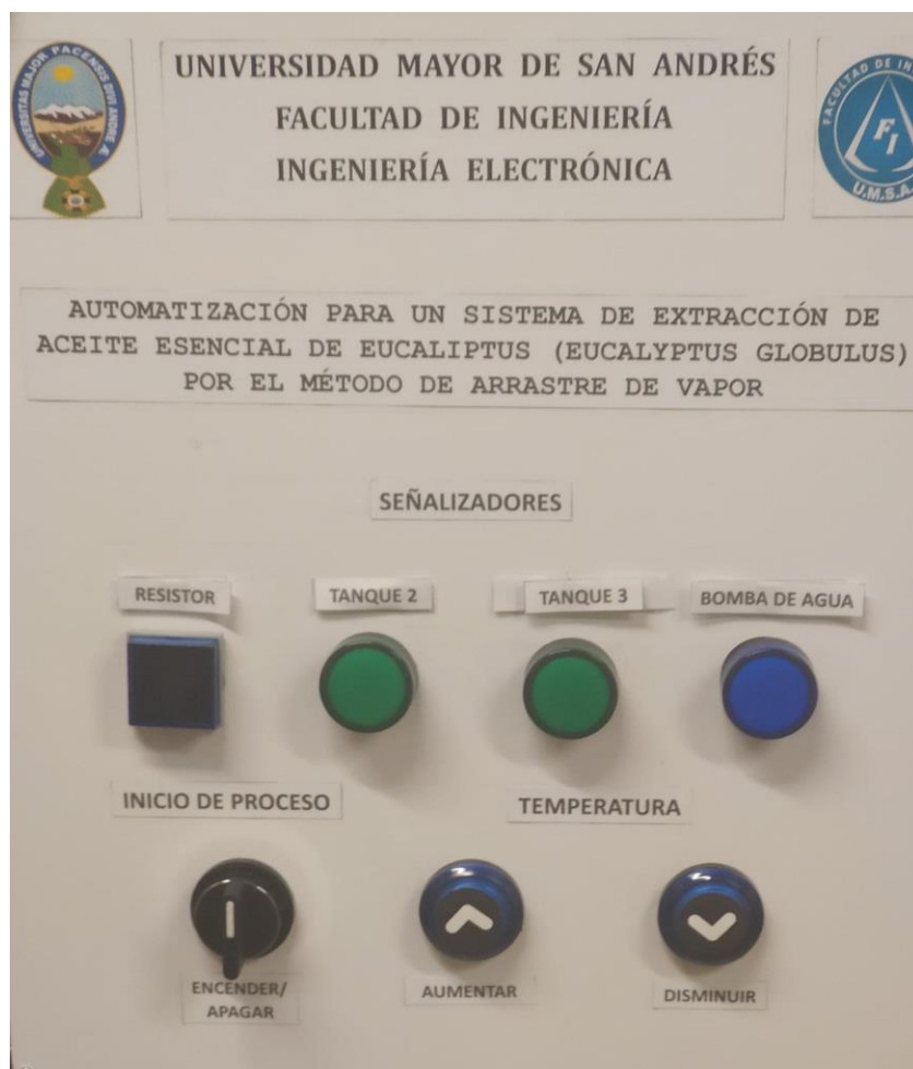
Figura 59 - Tablero de Mando.
